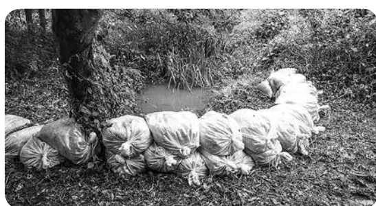
民間工事による被害箇所 (大谷木)
